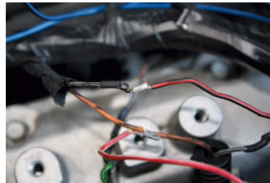
Schlimmer geht es nimmer: Kabel einfach verlötet. Das hält maximal bis zum ersten Schlagloch. Auch im Verfahren in Bremen wurde an den Fahrzeugen schwere Mängel festgestellt.
