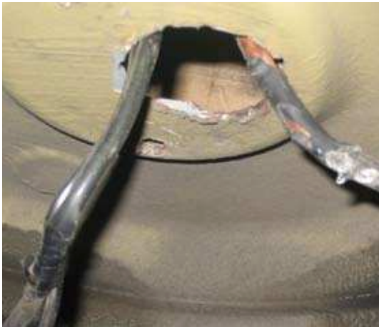
Der Gesetzgeber schreibt ausdrücklich vor, dass Gasleitungen an möglichen Scheuerstellen gegen Beschädigung zusätzlich geschützt werden müssen. In diesem Fall hat man stattdessen noch die Ummantelung entfernt.
