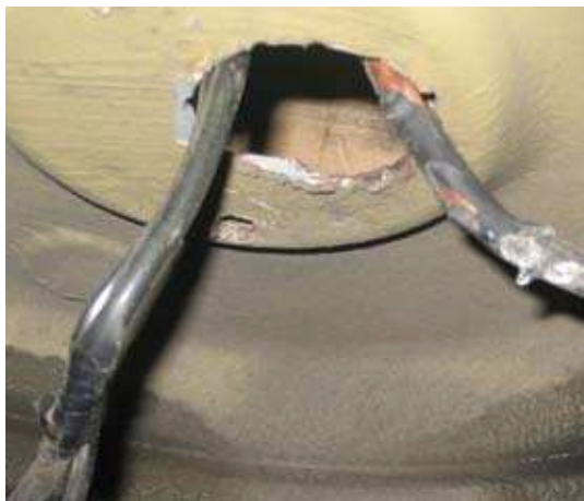
Der Gesetzgeber schreibt ausdrücklich vor, dass Gasleitungen an möglichen Scheuerstellen gegen Beschädigung zusätzlich geschützt werden müssen. In diesem Fall hat man stattdessen noch die Ummantelung entfernt.
